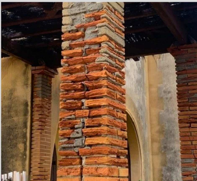
“Patologia en pilar de maó”
