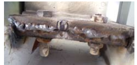
Soldadura amb múltiples defectes per una incorrecta execució
