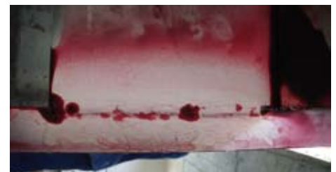
Indicacions amb múltiples defectes d'una soldadura inspeccionada per Líquids Penetrants
